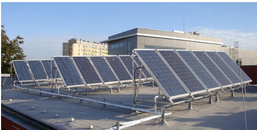
Rys. 1. System PV zainstalowany na dachu budynku Uniwersytetu Opolskiego [20]
